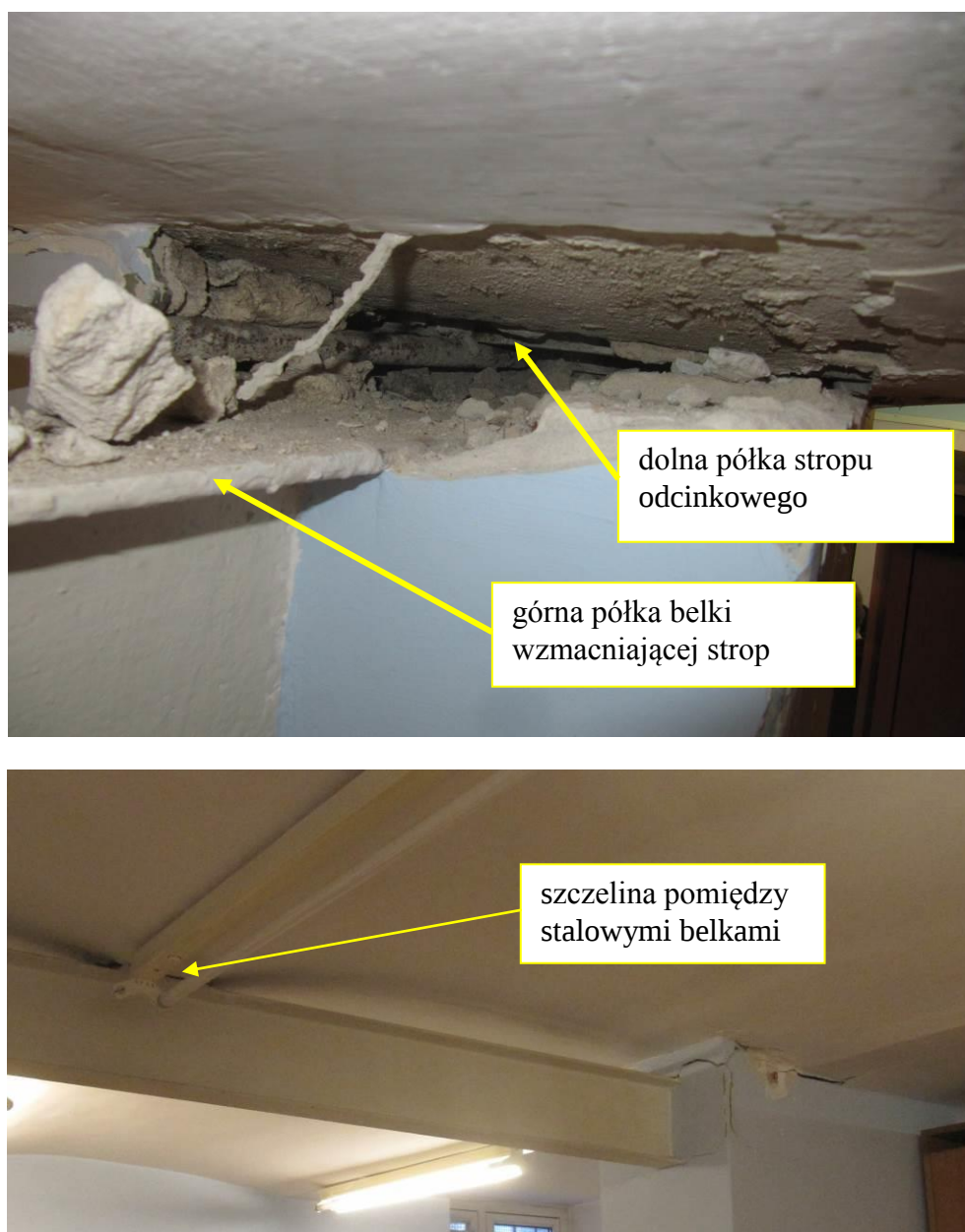
Rys. 11. Szczeliny pomiędzy belką wzmocnienia stropu a stalowymi belkami stropu odcinkowego
