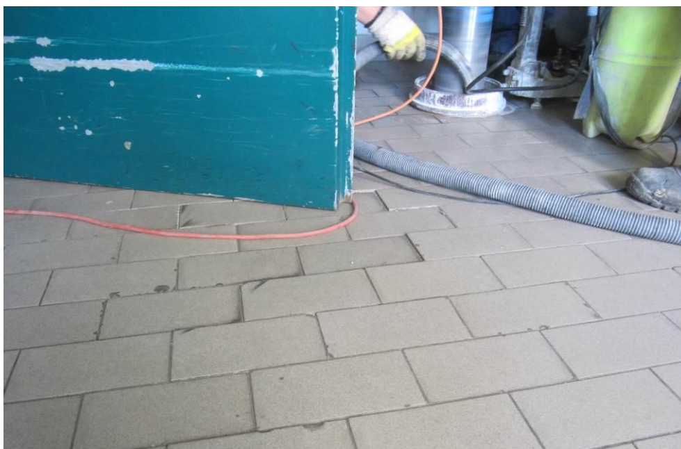
Rys. 8. Uszkodzenia (wybrzuszenie) posadzki w korytarzu
