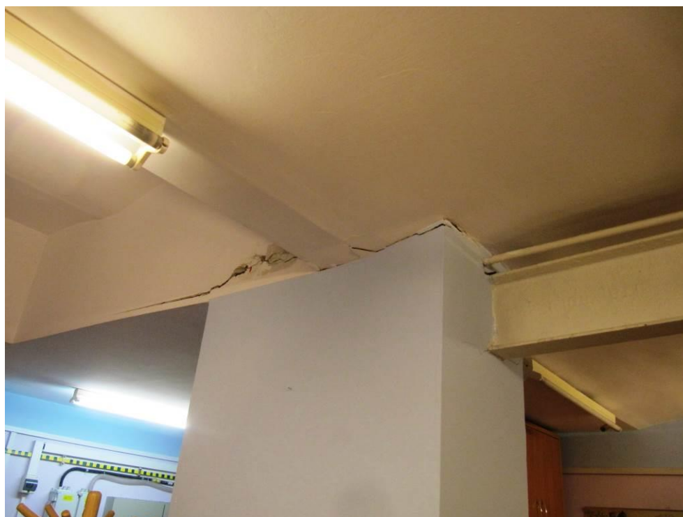
Rys. 3. Uszkodzenia pod stropem przy słupie
