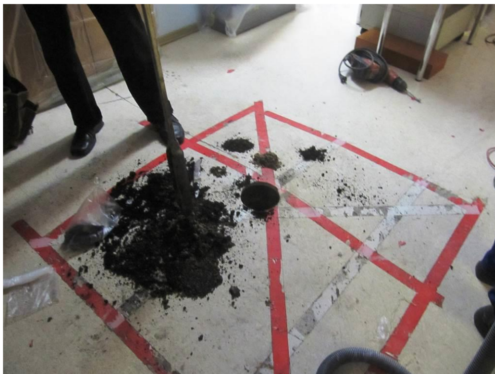
Rys. 2. Wybrzuszenie posadzki; widok w czasie wykonywania odwiertu i badań podłoża
