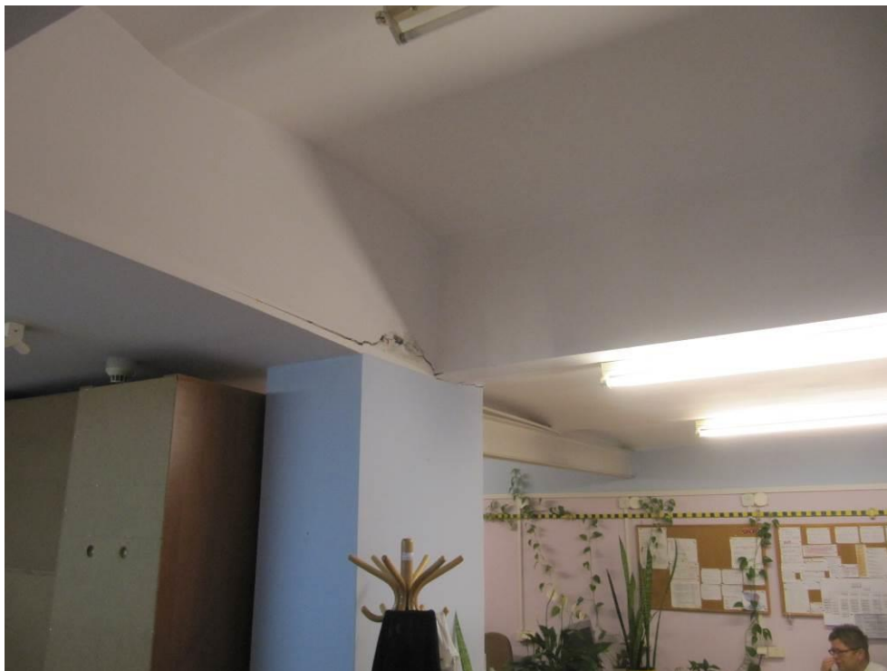
Rys. 4. Uszkodzenia pod stropem przy słupie
