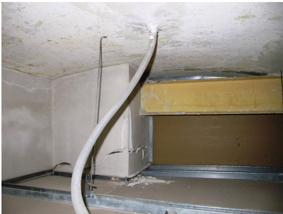
Rys. 5. Uszkodzenia słupa pod stropem; widok nad sufitem podwieszonym
